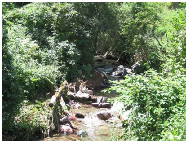
Porušen prag po neurju (Foto: R. Ferme, arhiv VGP Drava)
