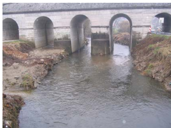
Očiščen profil železniškega mosta v Zbelovem na Dravinji (Foto: R. Kuzmič, arhiv VGP Drava)
