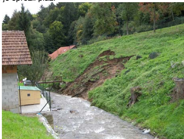
Ob Framskem potoku v Rančah se je dolvodno od letos saniranega plazu sprožil nov plaz, ki ogroža strugo potoka (Foto B. Roškar, arhiv VGP Drava)
