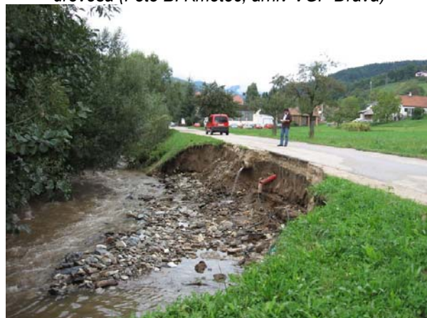
Dravinja v Zrečah, nad stadionom - poškodbe so na treh lokacijah (Foto B. Kmetec, arhiv VGP Drava)
