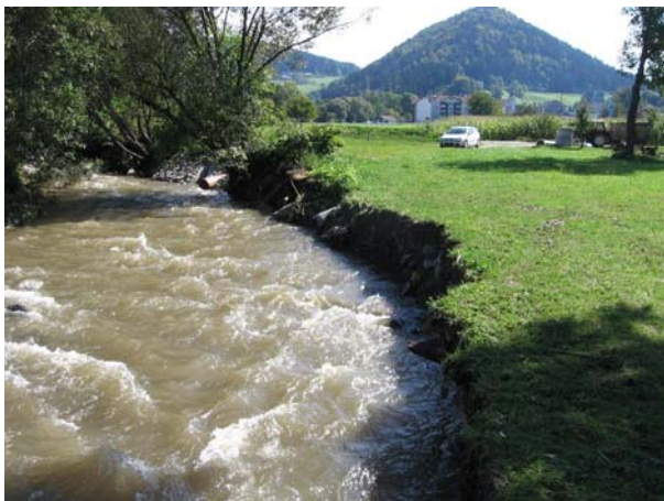
Zajeda v levo brežino struge Mislinje pri stari ČN; ogrožen glavni kanalizacijski vod (Foto: R. Ferme, arhiv VGP Drava)
