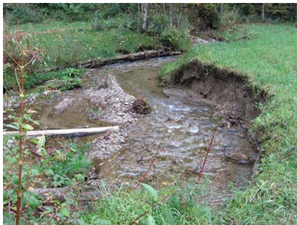
Zgornji ustalitveni prag na Šentanelski reki (Foto: R. Ferme, arhiv VGP Drava)
